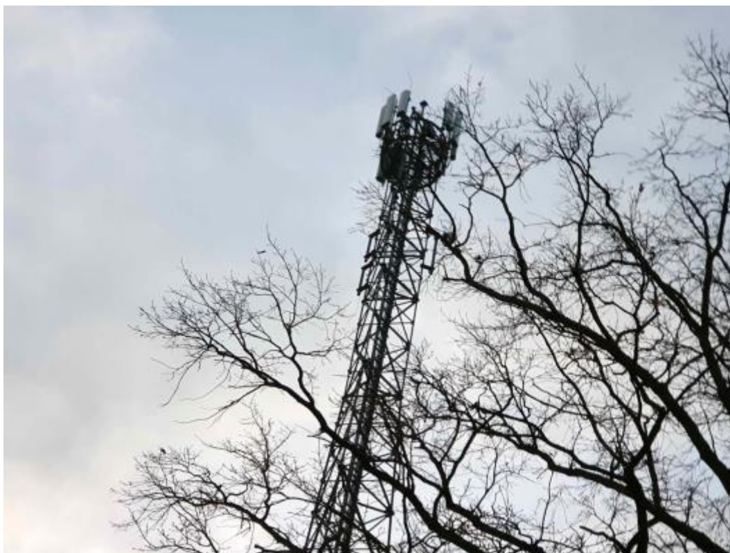
Ryc. 19 Zdjęcie anten masztu stacji bazowej telefonii komórkowej, Słupno, gm. Słupno.
